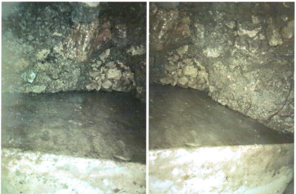
Фото 12 На наружной поверхности заглубленных участков наружных стен в местах возможного доступа (в районах технологических отверстий) выявлено: - гидроизоляция на поверхности бетона отсутствует; - бетонная поверхность стен подвержена интенсивному намоканию талыми водами; - разрушения бетона не выявлены.
