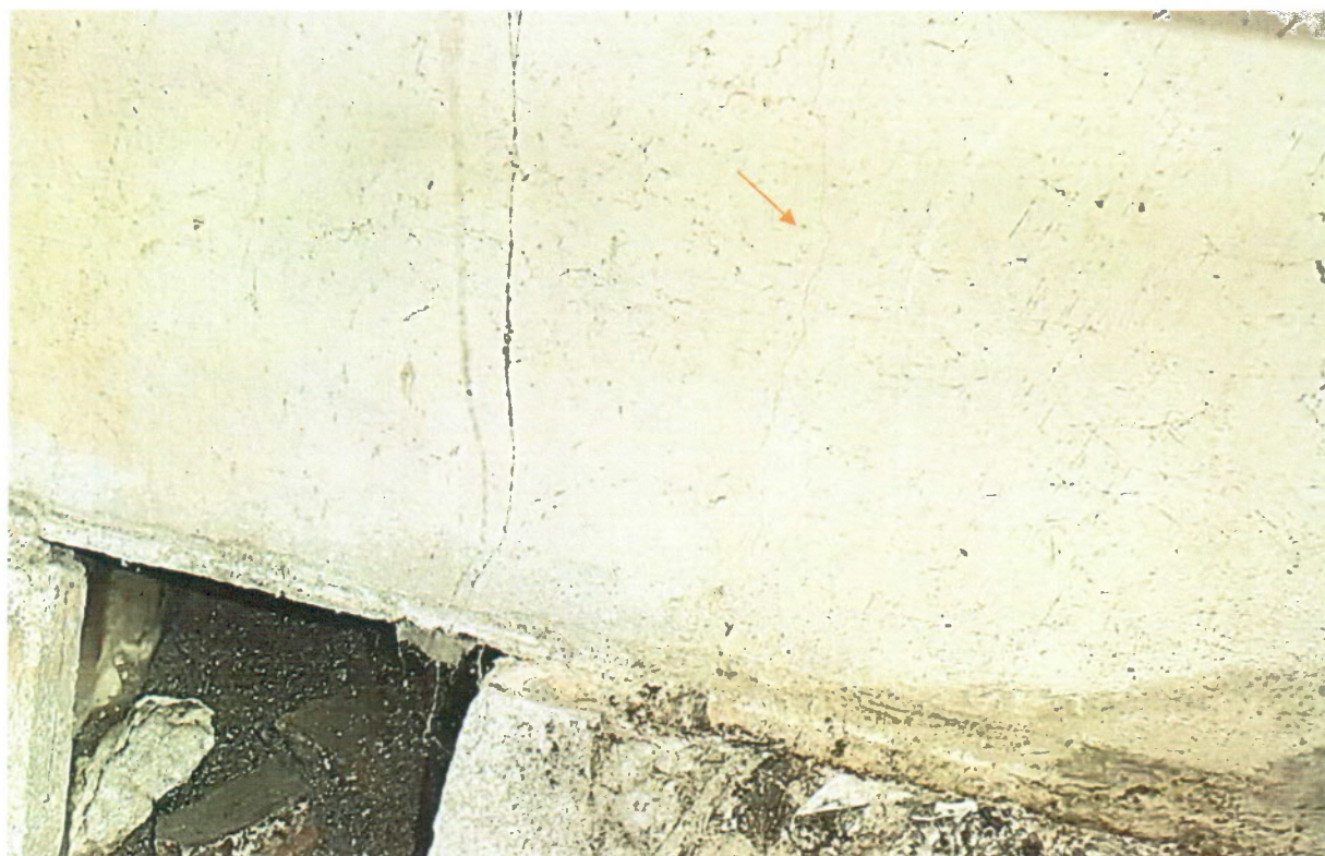
Фото 8 Вертикальная трещина шириной раскрытия до 0,3 мм на внутренней поверхности панелей наружной стены подвала в осях 6-7/А.
