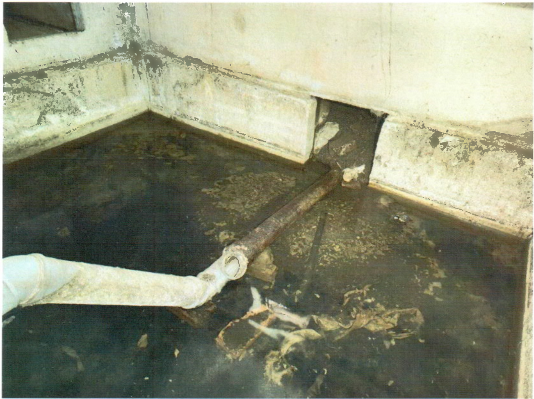
Фото 5 Негерметичный узел прохода труб ливневой канализации через стену подвала по оси А между рядами 9-10
