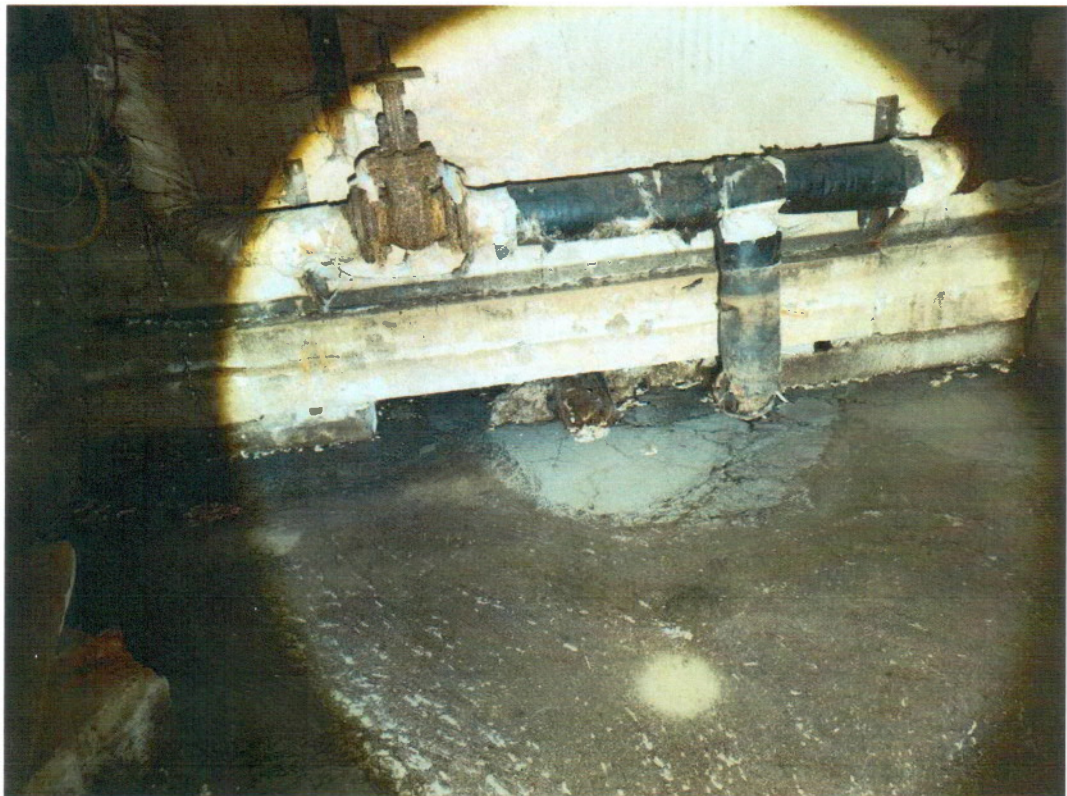
Фото 6 Негерметичный узел прохода водопроводной трубы через стену осях 14-15/А из технологического канала
