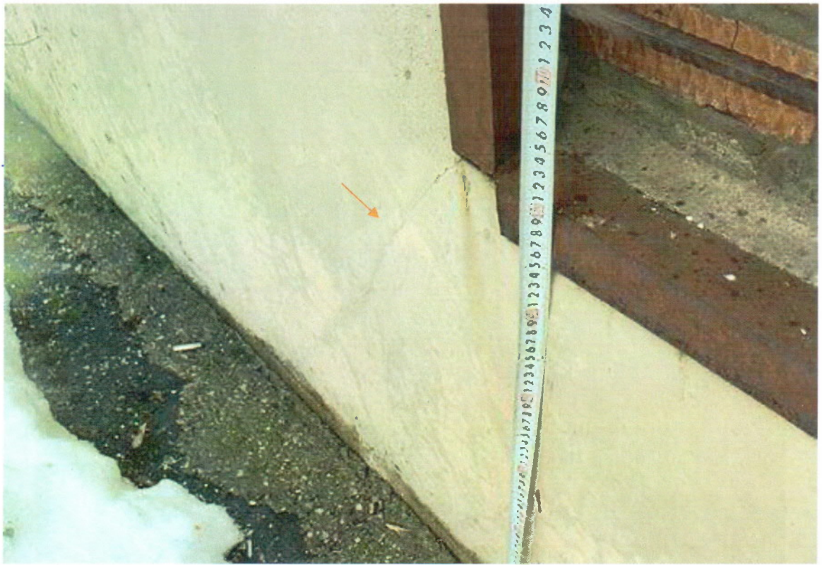
Фото 9 Наклонная трещина в стеновой панели подвала, отходящая от угла слухового окна.
