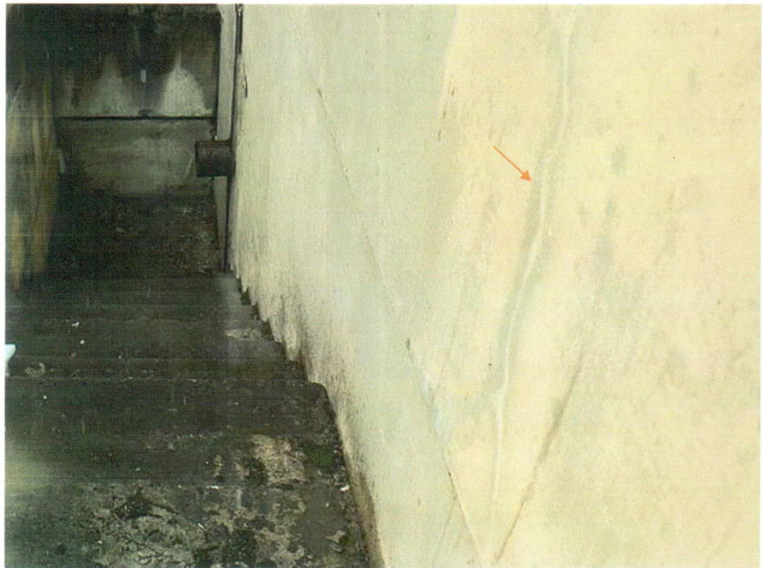
Фото 10 Трещина в стене в осях 15/Б-В
