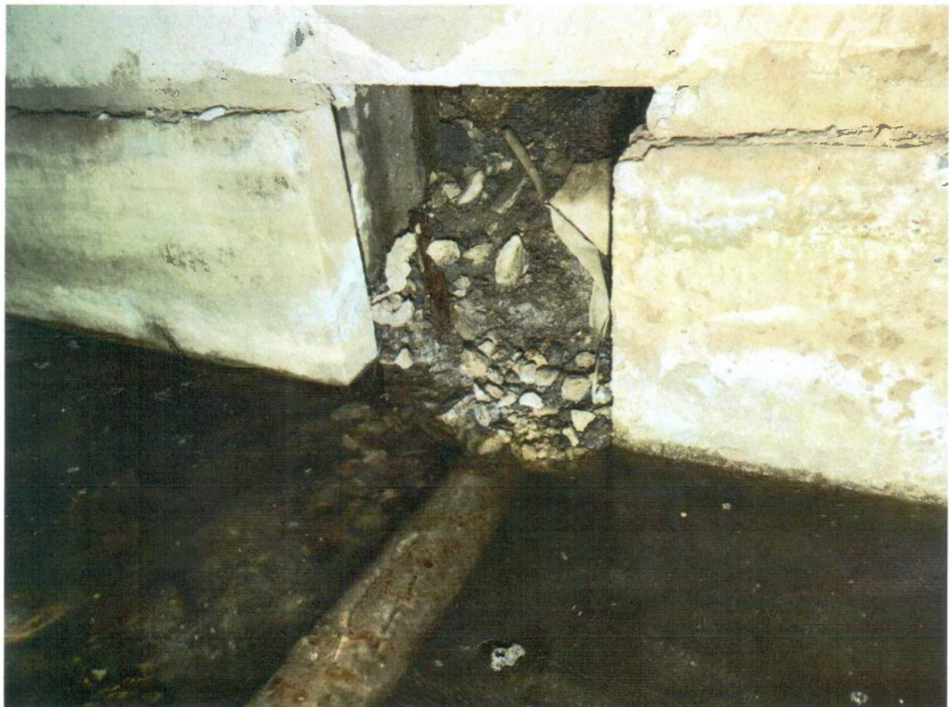
Фото 4 Негерметичный узел прохода труб ливневой канализации через стену подвала по оси А между рядами 6-7
