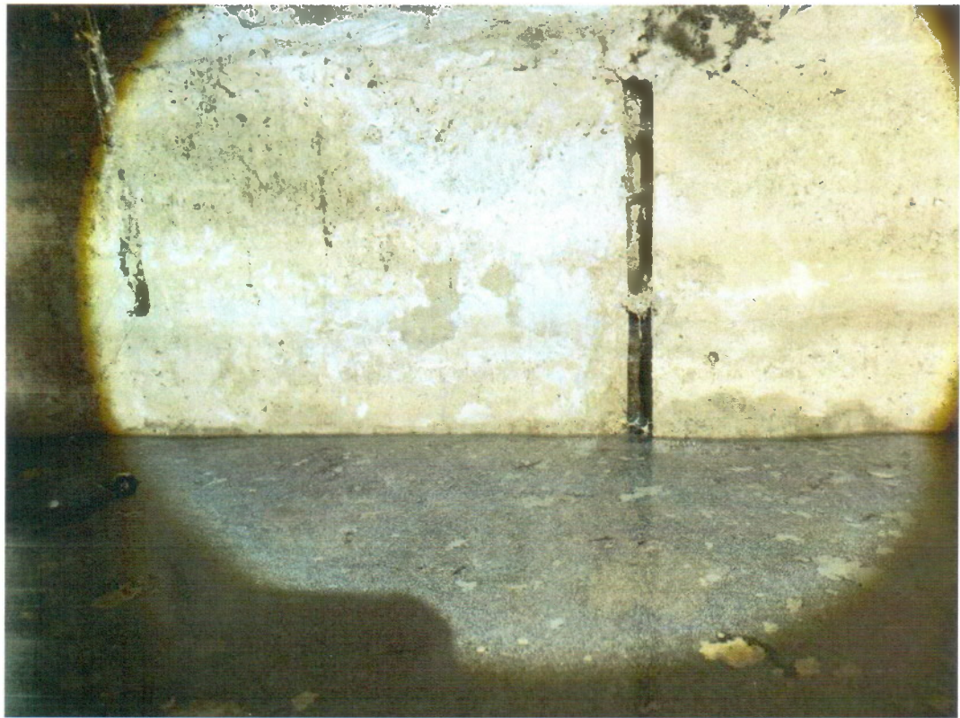
Фото 11 Участки шелушения бетона на глубину до 3 мм, следы намокания с признаками выщелачивания бетона на поверхности фундаментных блоков
