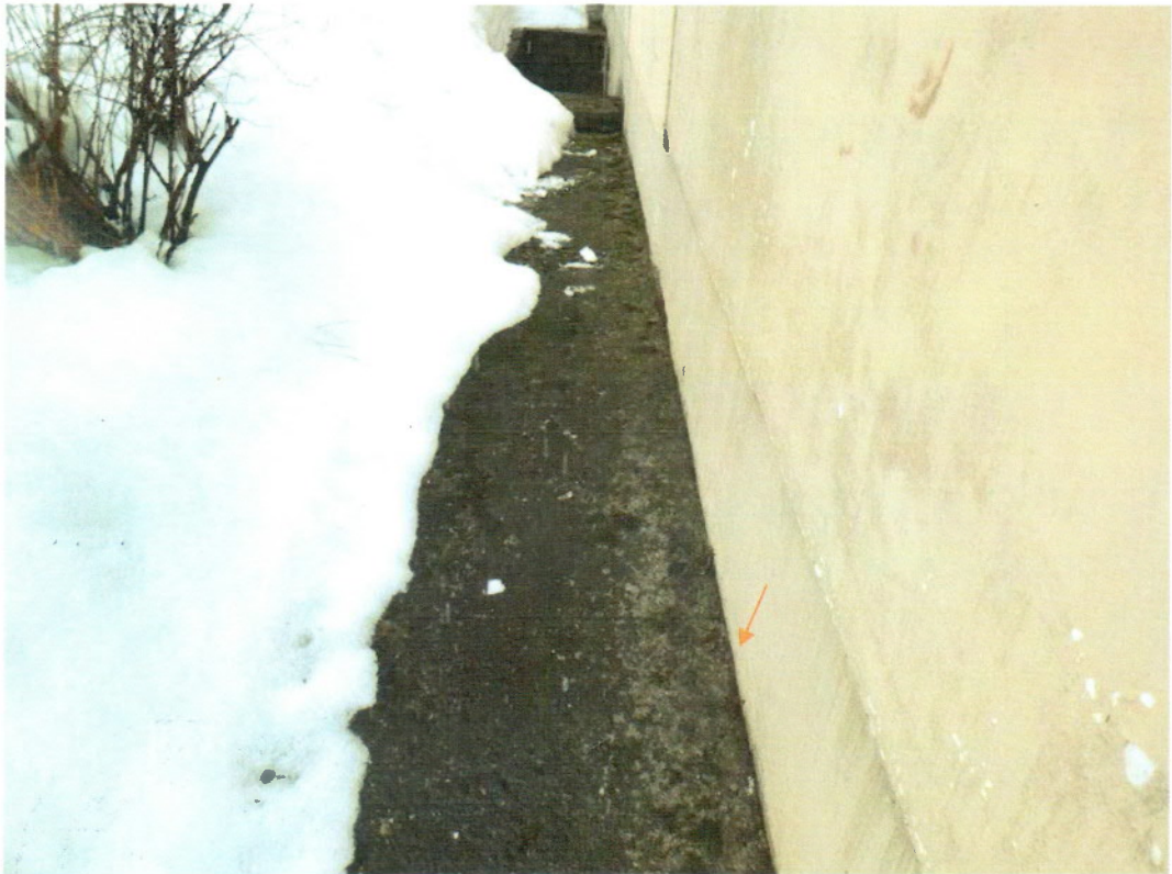
Фото 14 Нарушена герметичность стыка отмостки к стенам по всему периметру здания.
