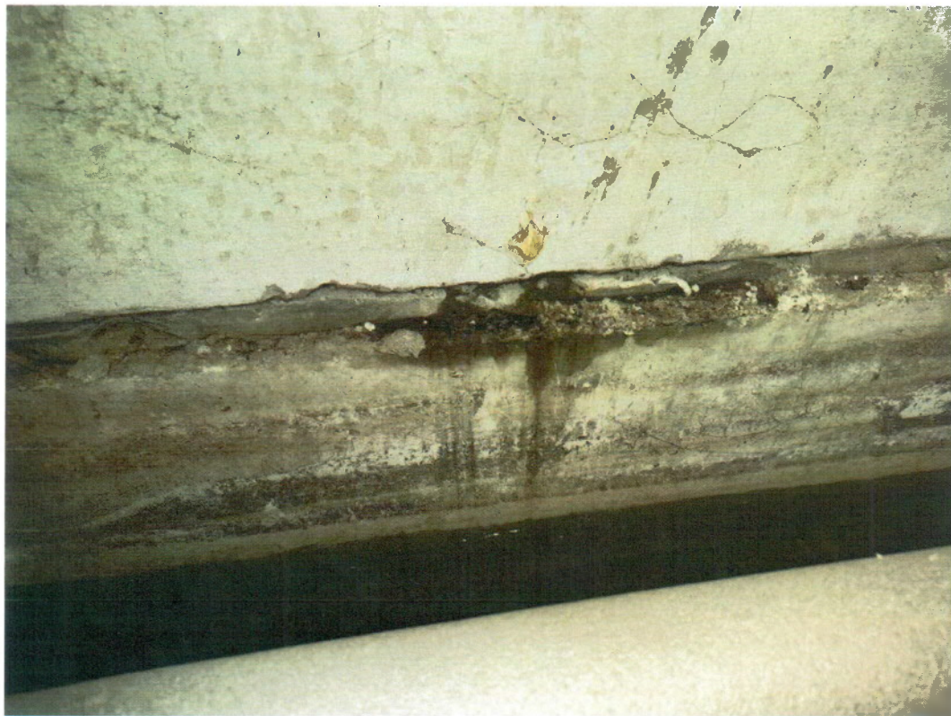
Фото 7 Локальные следы намокания в узлах сопряжения стеновых панелей наружных стен с блоками фундамента.
